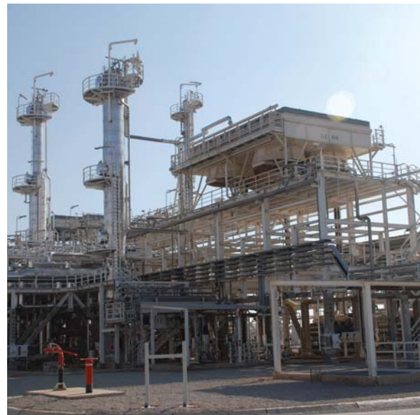
Газоперерабатывающий завод 1, Сирия. Ректификационные колонны
